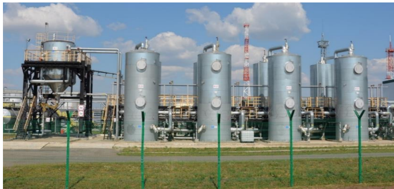
Рис. 2 - Установка предварительной очистки попутно добываемой воды (УПОПДВ)
