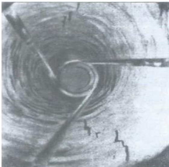
Рис. 1. Фотография вертикальной трещины протяженностью около 15 м в газовой скважине (трещина рассекает полость скважины)
