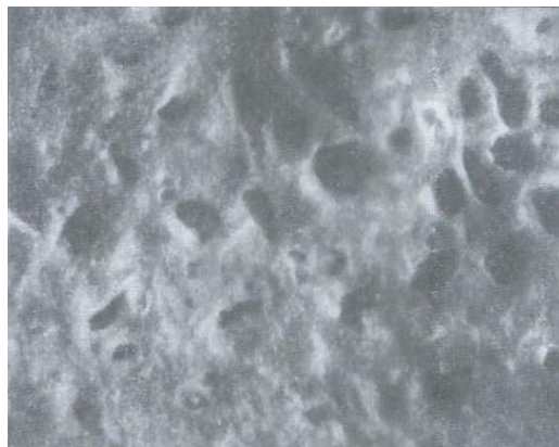
Рис. 3. Выщелоченная поверхность стенки вертикальной трещины
